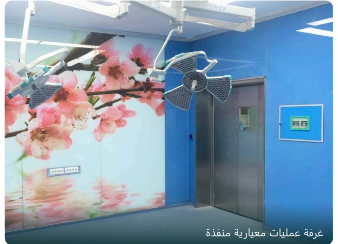
غرفة عمليات معيارية منفذة
